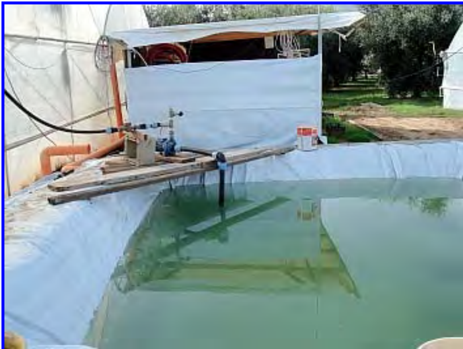
Idroserra: allestimento vasca per recupero e riciclo dell'acqua, pompa pescaggio e tubo di colmo
