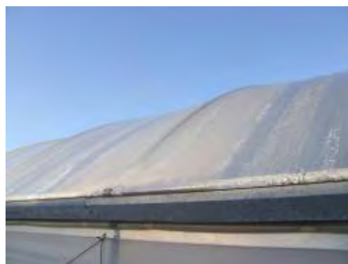
Grondaie installate per il recupero dell'acqua
