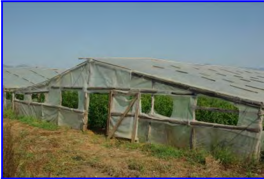
Fondi 2011: idroserra in legno degli anni 70, ancora in attività , si noti la presenza del tubo antibrina sul colmo
