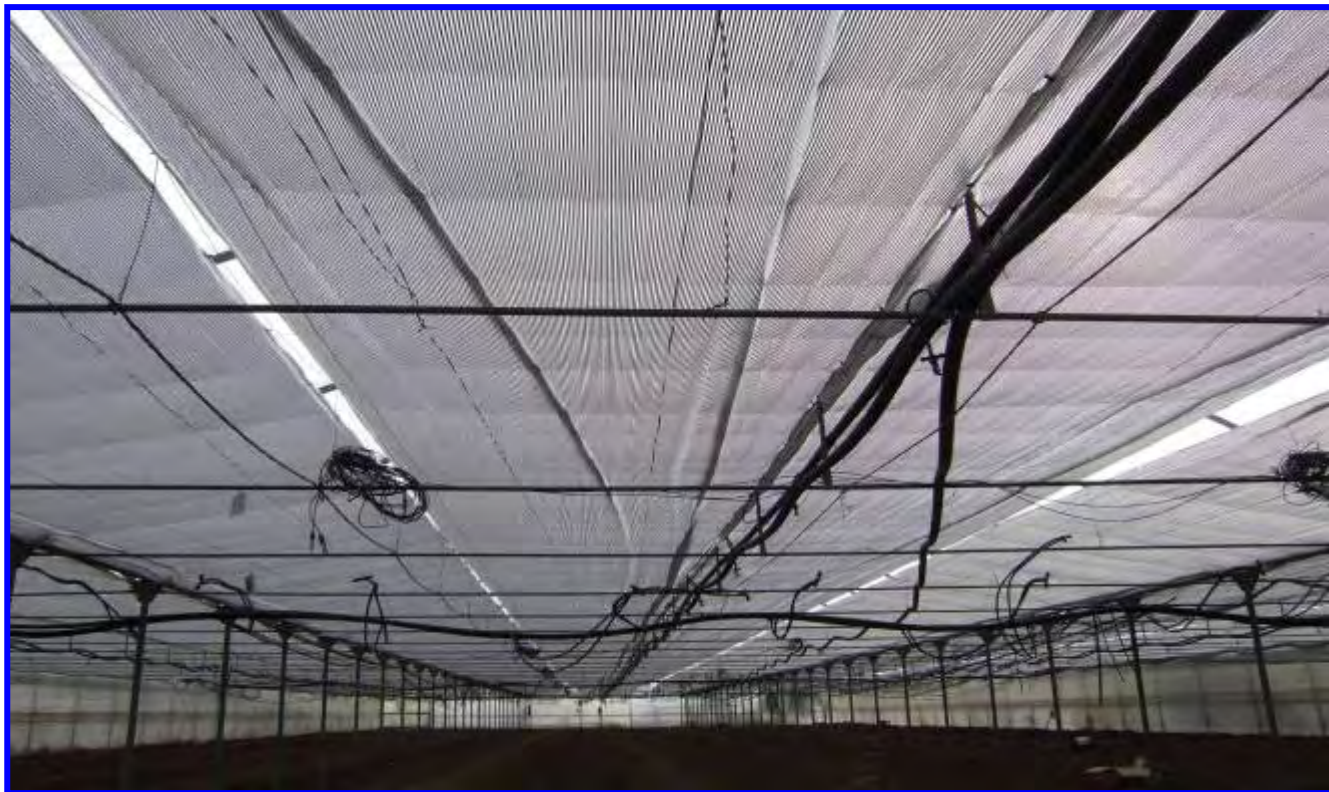
Una visione degli schermi termici distesi sull'orditura dei cavetti che li sorreggono.
