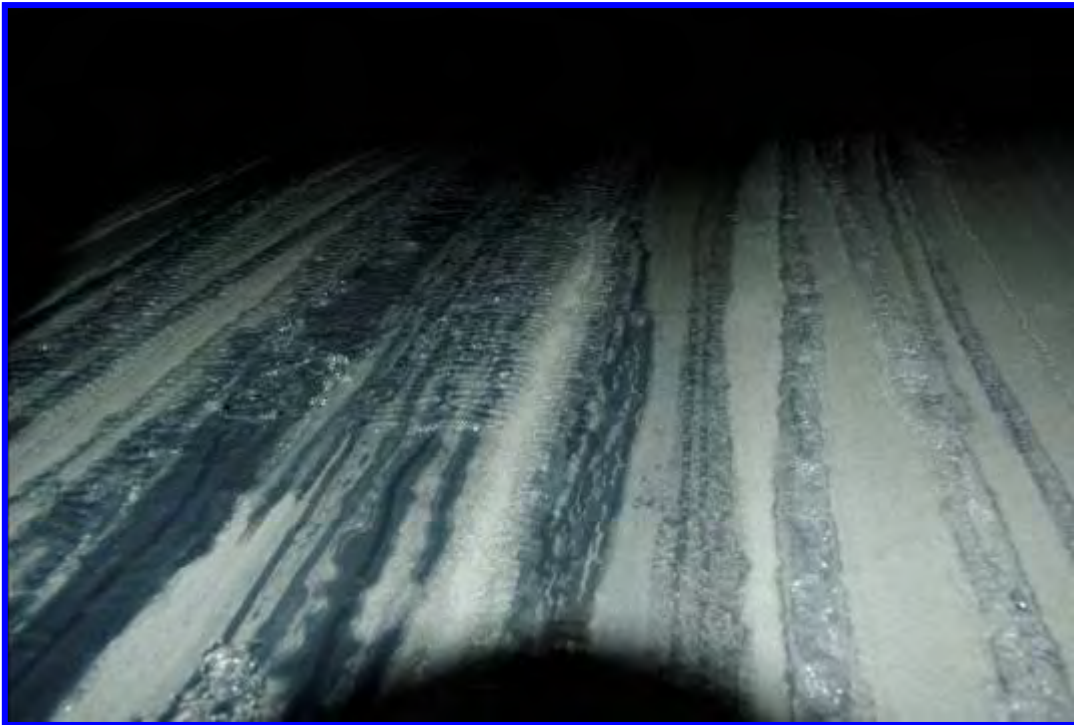
La formazione e deposito del ghiaccio nella parte centrale della copertura compresa tra due archi
