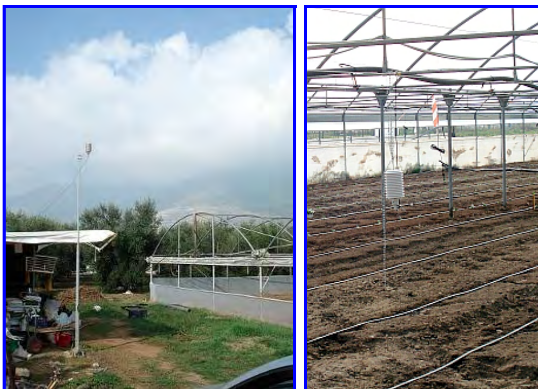
Idroserra: a sinistra il sensore temperatura aria esterna; a destra sensore temperatura aria centro serra
