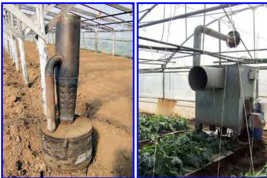
Immagini di sistemi di riscaldamento alternativi all'idroserra esistenti nell'agro fondano: a sin. antiche stufe a gasolio in serre con struttura in legno (ormai desuete); a destra generatore ad aria calda a gasolio
